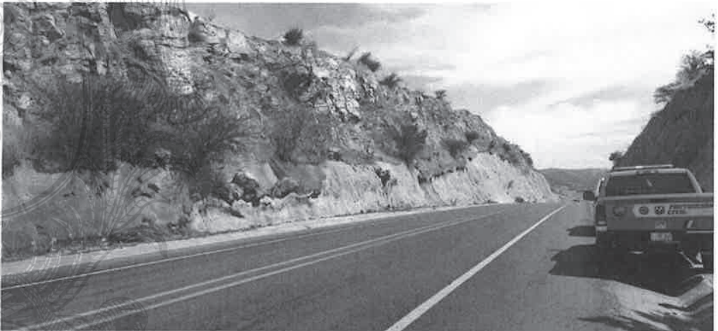
Presencia de laderas susceptibles por inestabilidad en Carretera Silao – San Felipe. Fuente: (CEPC, 2021).
